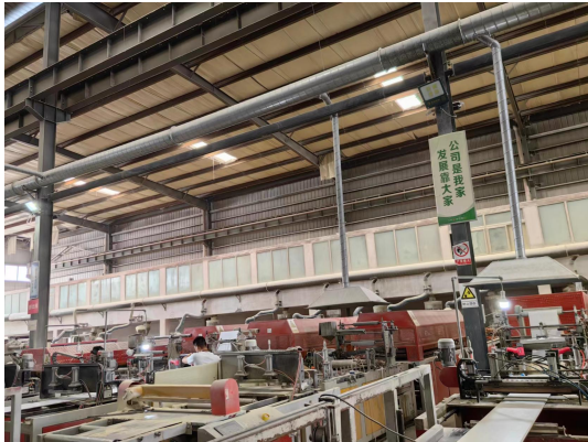
挤出成型区废气收集管道
