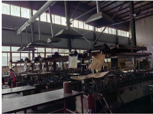
包覆区废气收集设施
