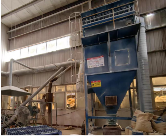
原料加工车间粉尘治理设施布袋除尘器
