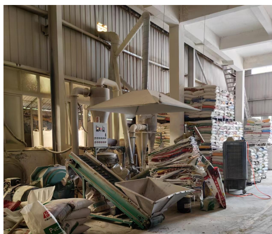
下料粉尘收集设施
