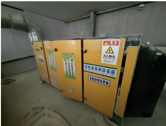
有机废气处理设施
